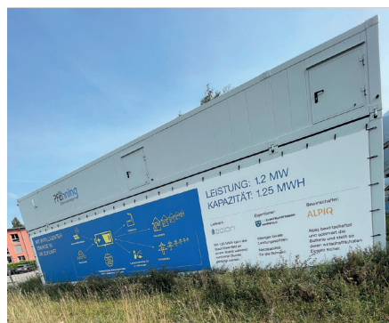
Un'unità di accumulo con una batteria contribuisce a stabilizzare la rete.
